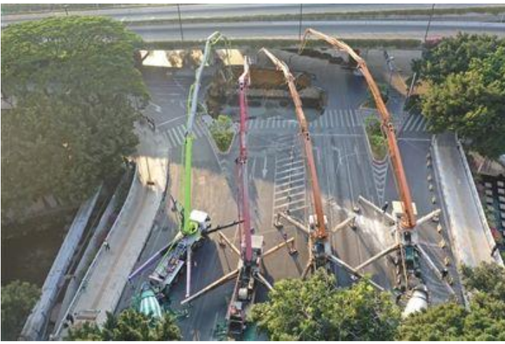
地表塌陷灾害
